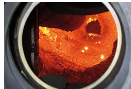
Four de la cimenterie de Val d'Azergues (Rhône-Alpes)
